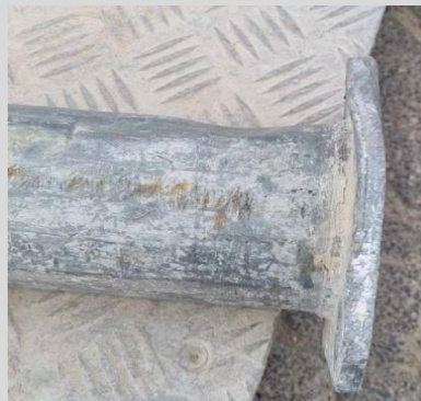
11. Odształcenie elementu – podpora TUP, bez pęknięć
