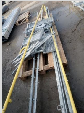
Uszkodzenie niedozwolone – przykład rozkręcone całkowicie schody
