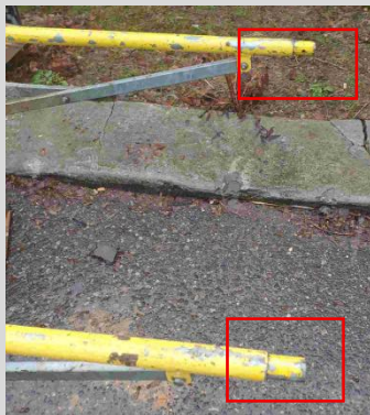
Uszkodzenie niedozwolone – element do wymiany
