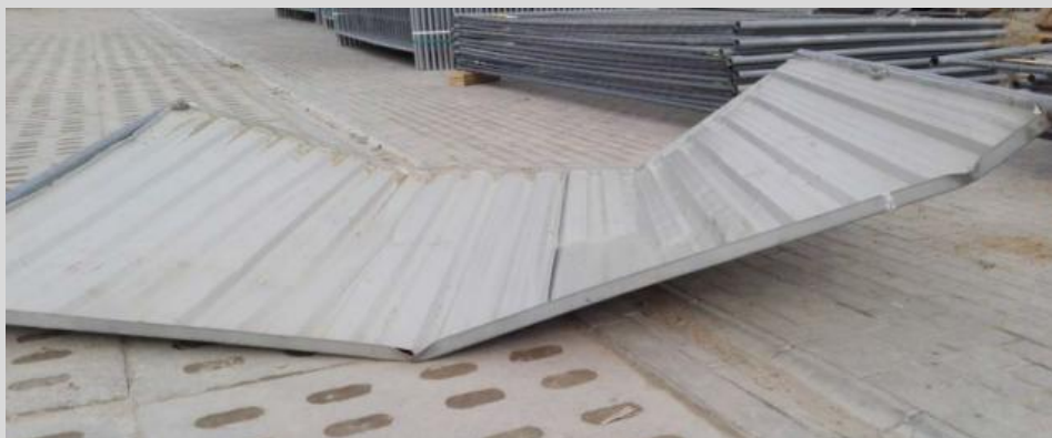
Uszkodzenie niedozwolone – element do KASACJI
