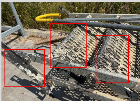
Uszkodzenie niedozwolone - element do KASACJI
