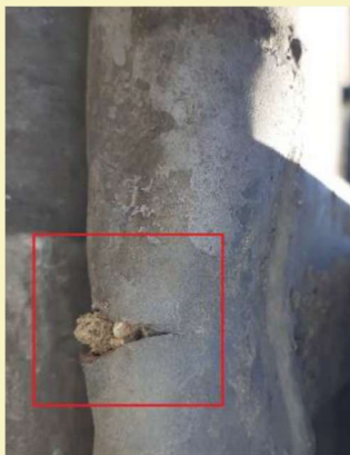
13. Pęknięcie słupka pionowego
